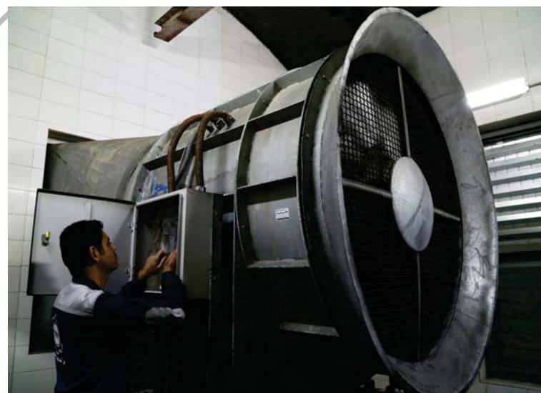
▲ نظارت بر مهندسی تامین، نصب و راهاندازی سامانه تهویه - خط ۳ مترو تهران
